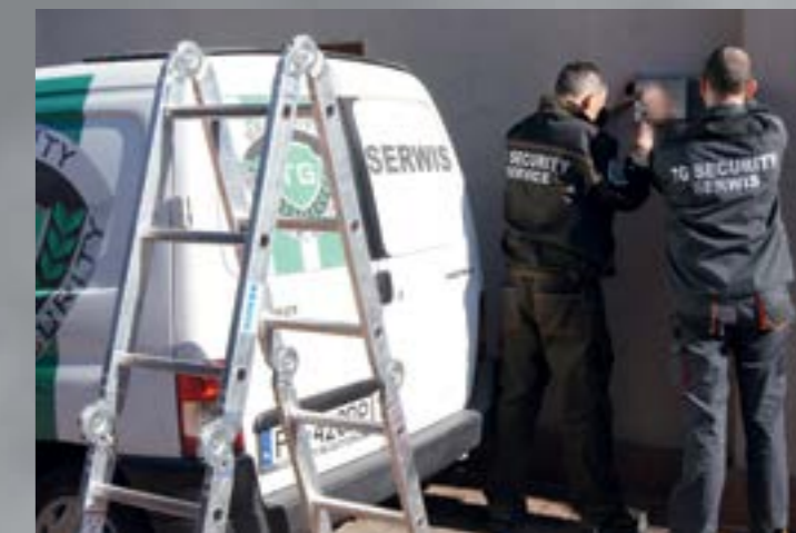
Serwis 24h - montaż telewizji CCTV, alarmów itp.
